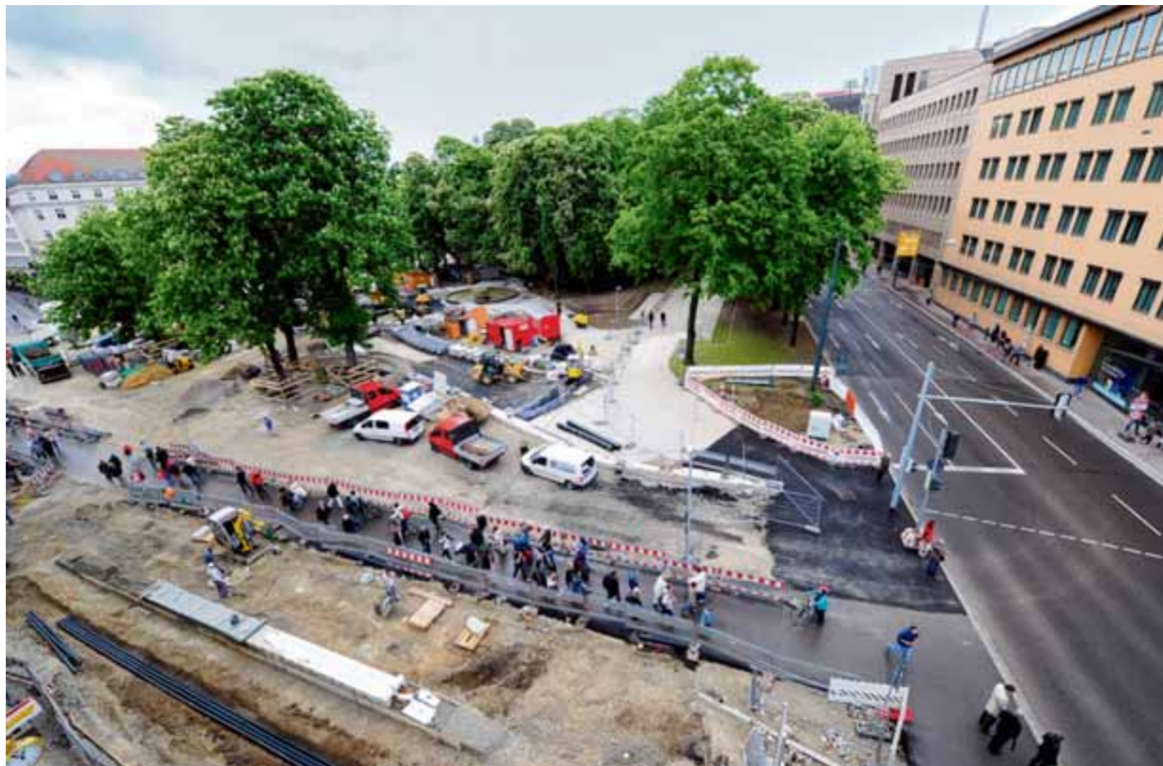
Baustelle Kö-Park: Vorne laufen Passanten dort, wo früher die kurze Bahnhofstraße war. In den kommenden Monaten entsteht eine gepflasterte Fußgängerzone, die sich bis in den Kö-Park erstrecken wird. Als erster Baustein wurde gestern der Rad- und Fußweg im Park entlang der Schaezlerstraße (rechts im Bild) eröffnet. Foto: Silvio Wyszengrad
